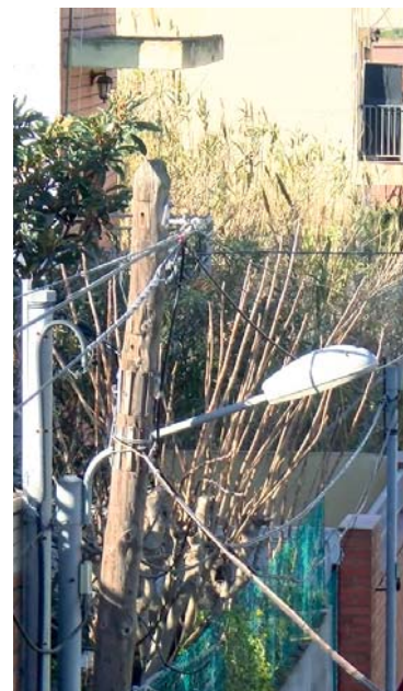
Cablejat elèctric a Can Sant Joan
