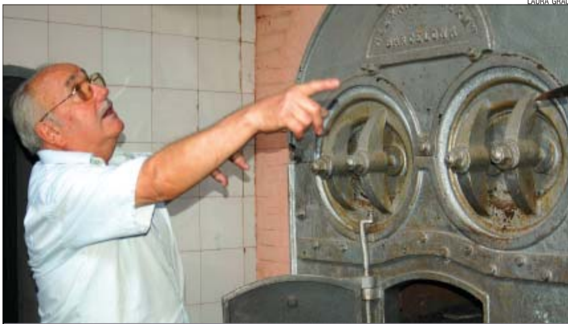
>> Joan Roviralta encara recorda com funcionaven les calderes de la Casa de les Aigües
