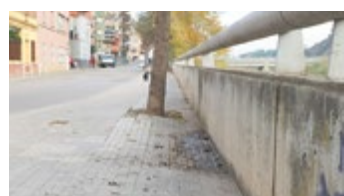
Les deficiències d'asfaltat i voreres
