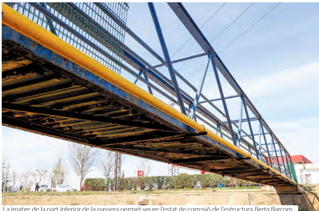
La imatge de la part inferior de la passera permet veure l'estat de corrosió de l'estructura Berta Barcons
